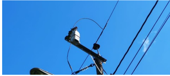
Figura 3. TripSaver No. 7286 Instalado.
