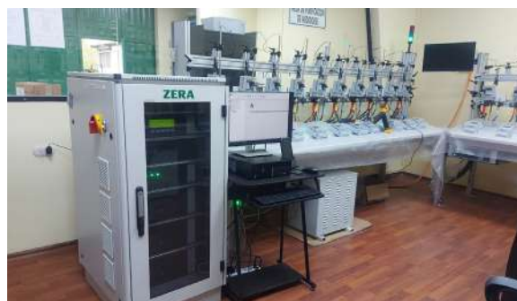
Figura 1. Laboratorio de Medidores de la EEASA
