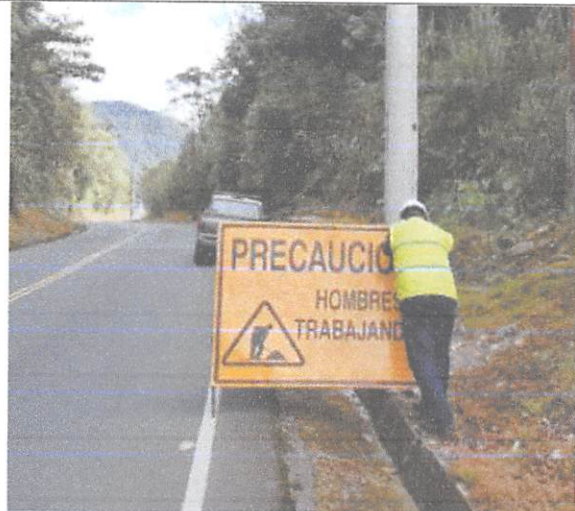
Señalización en vía
