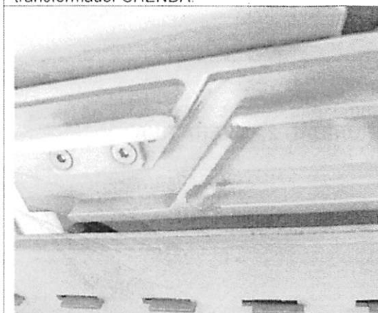
Fotografía 7. Desgaste en base de interruptor 52MT21 lado izquierdo.
