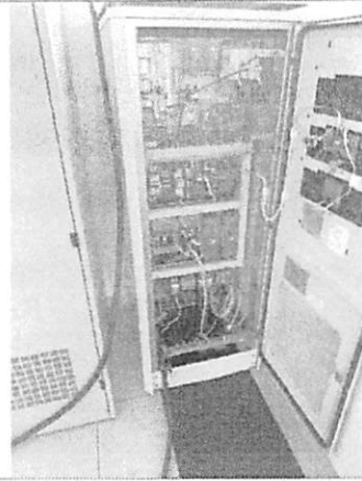
Fotografía 2. Cargador de baterías alimentado por acometida externa S/E Puyo 1.
